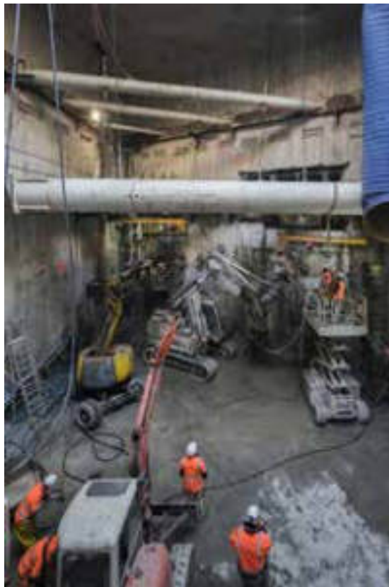
Vue d'ensemble atelier de forage de congélation - Overview of freezing drilling work area
