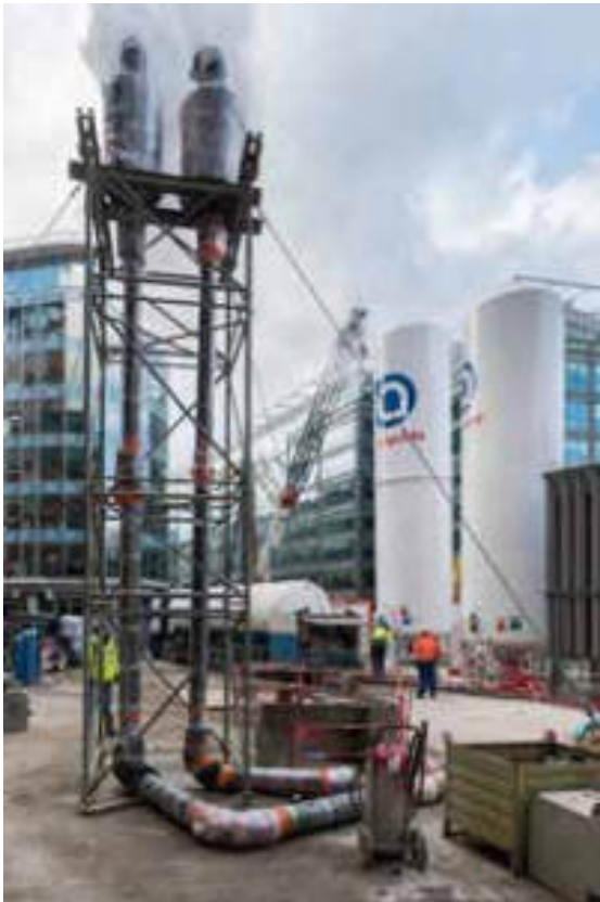
Figure 18 : Cheminées d'évacuation d'azote - Nitrogen evacuation chimneys
