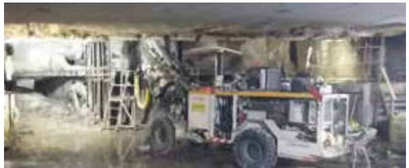
Figure 5 : Réalisation d'une auréole de boulons forepoling au mini pantofore - Construction of a forepoling bolts halo with mini pantofore
