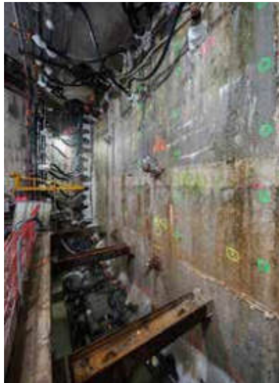
Figure 17 : Front côté CSO avec vue sur la congélation - Front on CSO side with view on the freezing
