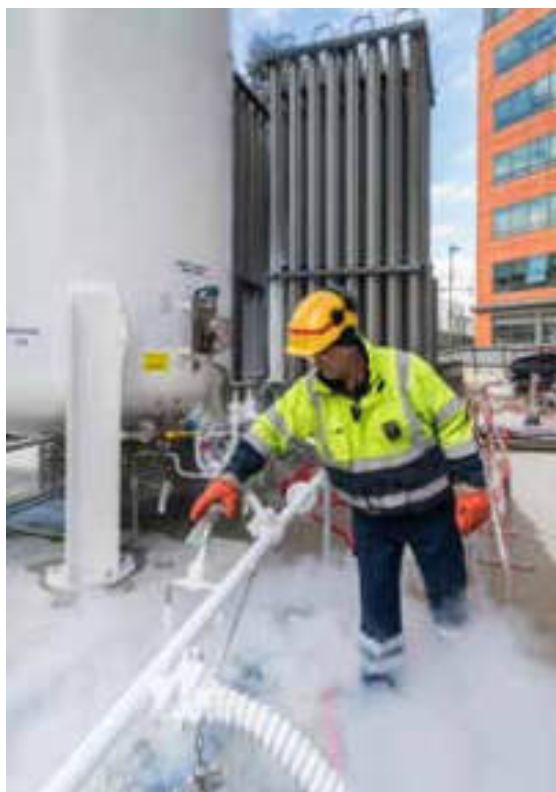
Figure 20 : Remplissage silo d'azote - Filling nitrogen silo
