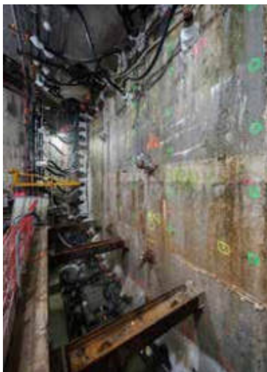
Figure 17 : Front côté CSO avec vue sur la congélation - Front on CSO side with view on the freezing
