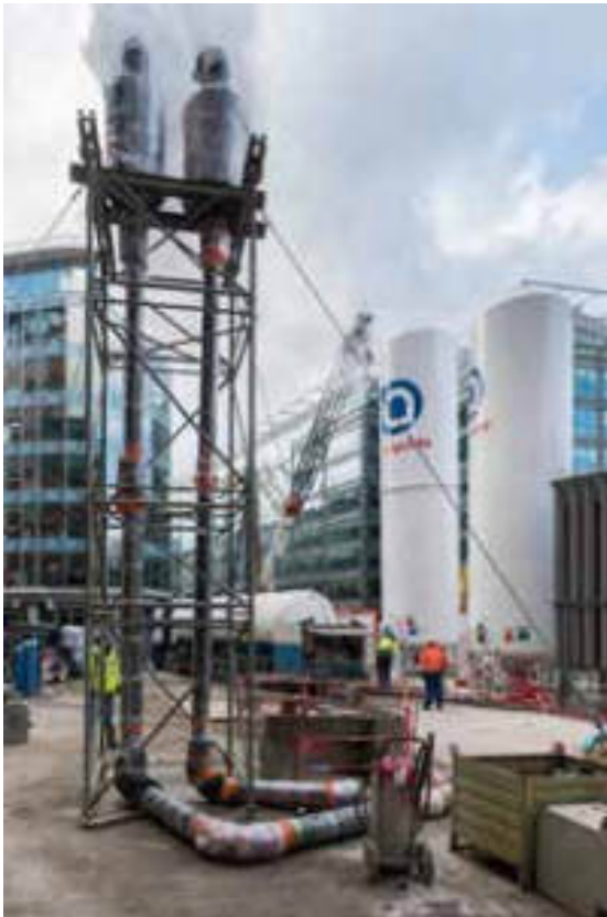
Figure 18 : Cheminées d'évacuation d'azote - Nitrogen evacuation chimneys
