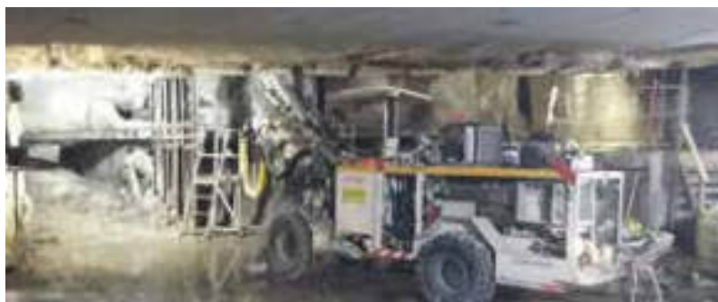
Figure 5 : Réalisation d'une auréole de boulons forepoling au mini pantofore - Construction of a forepoling bolts halo with mini pantofore
